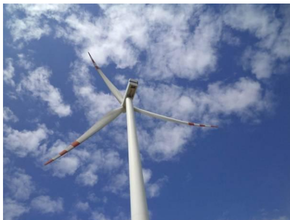
Fotografia VI.1. Elektrownia wiatrowa w województwie zachodniopomorskim (źródło: WIOŚ w Szczecinie)
